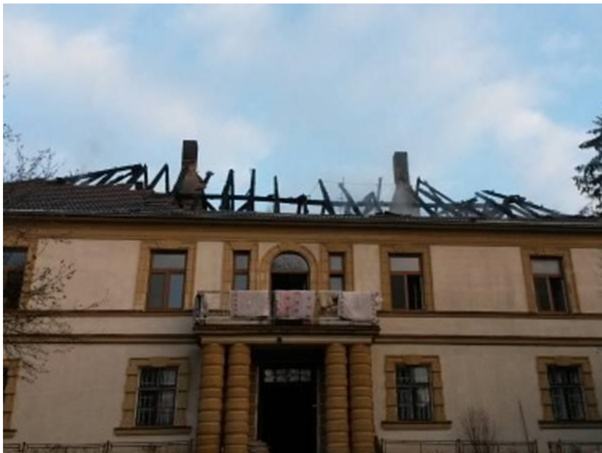
Požárem poškozená střecha. Autor: Hasiči MSK
